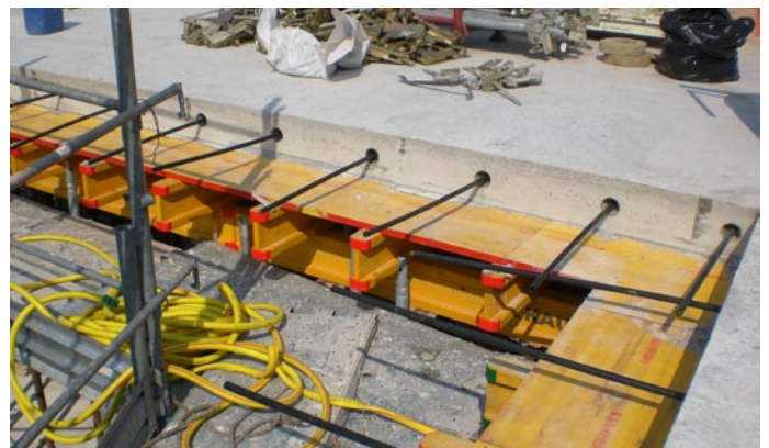
Cavi monotrefolo con cavi scorrevoli prima della tesatura
