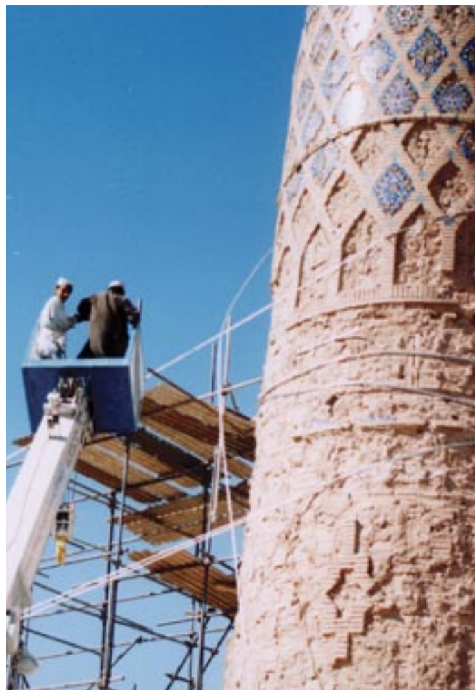
Afghanistan, Minareto di Herat Messa in sicurezza attraverso cerchiatura esterna mediante sistema Algacable T15 e tesatura di due stralli Alga AL200.
