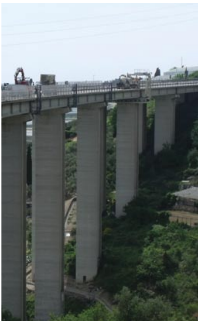
Autostrada dei Fiori, Viadotti Rio Gozzo e San Lorenzo. Adeguamento sismico con sollevamento dell'impalcato e sostituzione di appoggi e giunti con dispositivi antisismici e chiavi di taglio.
