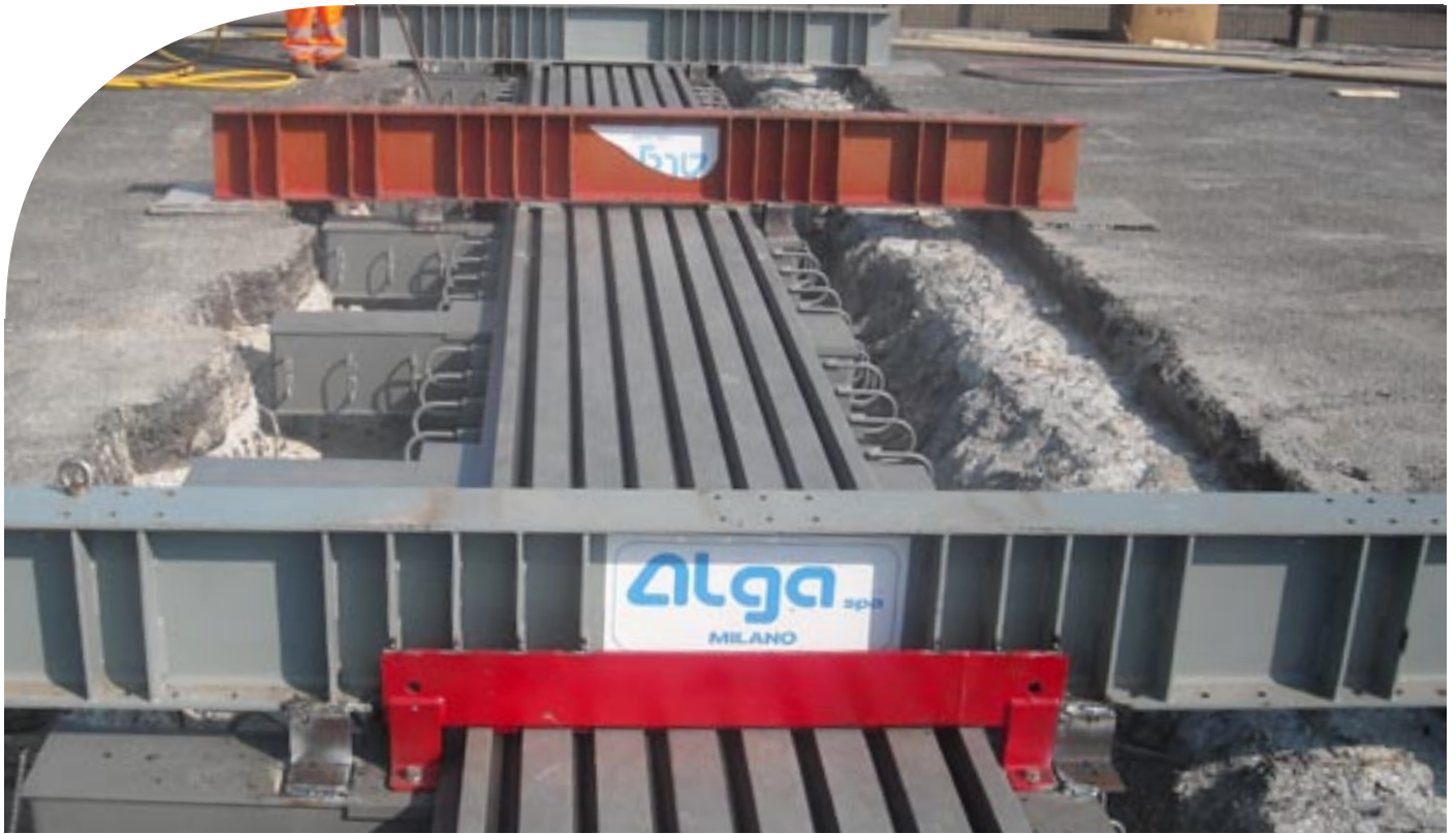
Autostrada A26 "Dei Trafori", Viadotto De Amicis: Sostituzione di giunto ammalorato con giunto a lamelle di grande escursione.
