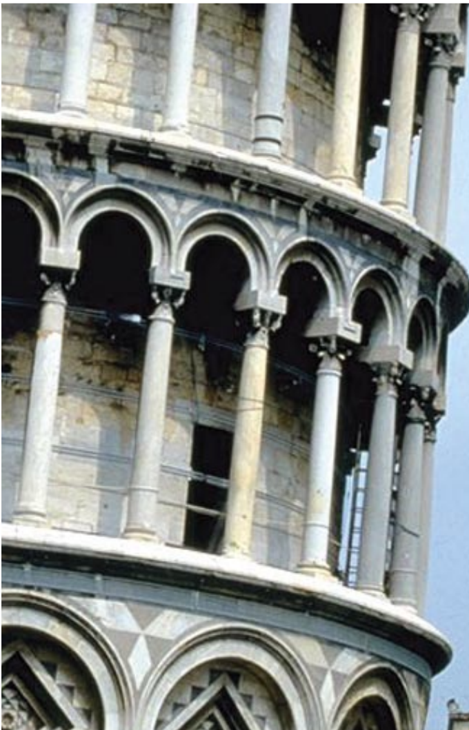
Pisa, Piazza dei Miracoli Stabilizzazione della Torre attraverso l'irrigidimento del dado di fondazione e della zona in corrispondenza del primo loggiato mediante cerchiatura con cavi esterni post-tesi.
